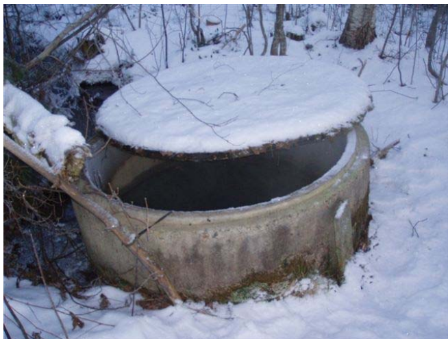
Kunnostuksen tarpeessa oleva rengaskaivo
